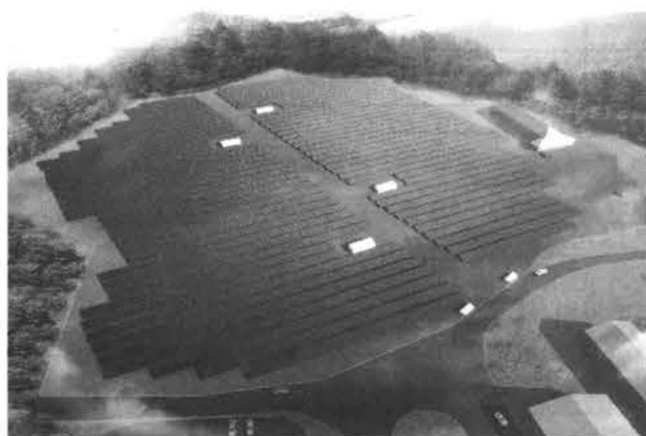
当社が手がけた案件のひとつの「宇都宮プロジェクト」。出力容量は1.999kW+1.999kW、敷地面積は約5万㎡で2013年10月に竣工
